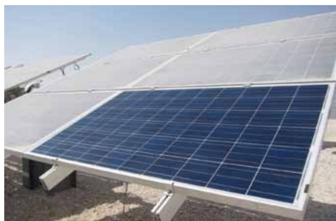
Die Verschmutzung von Solarmodulen mit Sand und Staub mindert die Erträge in Wüstenregionen.
